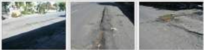
KONDISI JALAN YANG RUSAK SEPANJANG JALAN WATUBENGGONO SEHINGGA PERLU DIPERIKSA DAN DIPERAWAT
